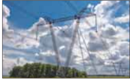
45-сүрәт. Лайиһәләнгән күчиниши 1150 кВ «Экибастуз – Көкшетау» электр йәткүзгүчи линиялири
