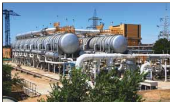
Рис. 49. Опреснительная установка в Актау
