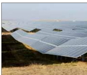
Рис. 33. Солнечная электростанция «Бурное Solar-1» в Жамбылской области
