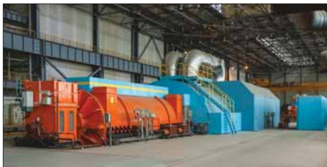
249-сүрәт. Электр станциясиниң машина залы. Һо генератори.
